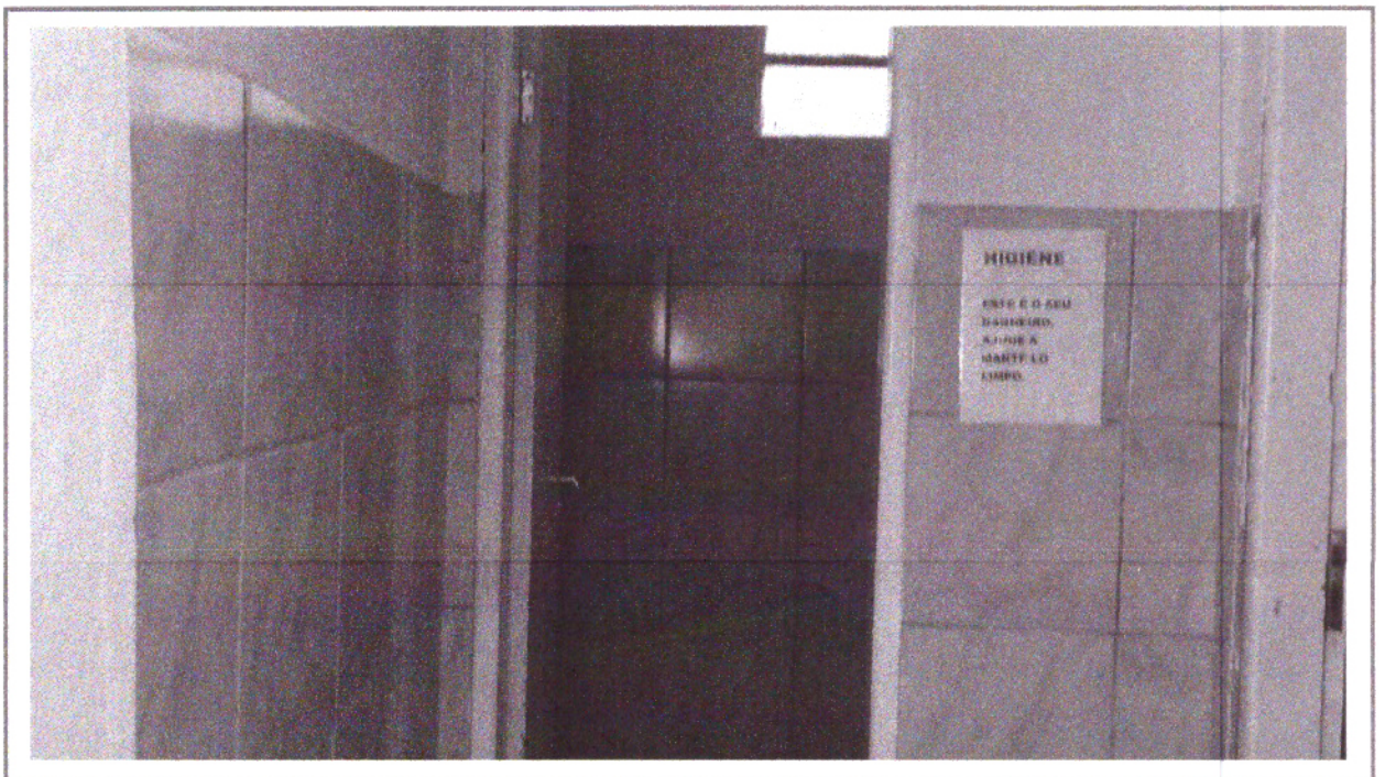
Figura 6 – Porta e revestimento interno do banheiro feminino a serem removidos
