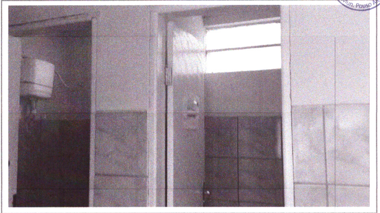
Figura 5 – Portas e revestimentos internos do banheiro masculino a serem removidos
